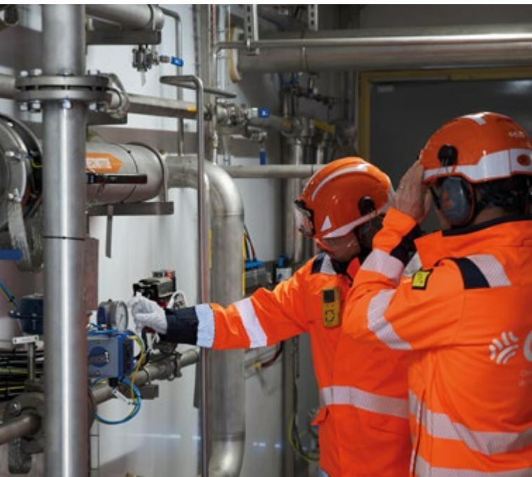
Chargés d'exploitation CVE Biogaz Services sur le site d'Equimeth
